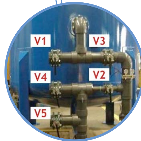
Válvulas de un Filtro en profundidad
